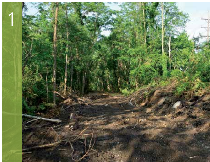
1. LA PREPARAZIONE DEL PERCORSO LUNGO LA VECCHIA LINEA FERROVIARIA OLD RAIL PATH DURING TRAIL DEVELOPMENT
